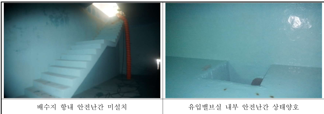
【사진 3.9】 추락방지시설 손상사진
