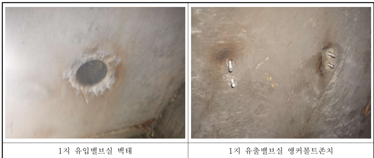
【사진 3.4】 유입 · 유출 밸브실, 유량계실 손상사진
